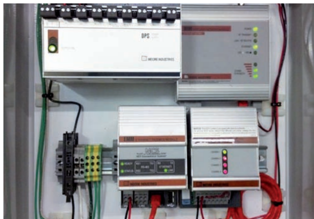
Bezdrôtový prijímací panel inštalovaný v kotolni celulózy a papierne. Modul rozhrania EMM Ethernet/MODBUS systému koncentrátora NCS NET slúžil ako MODBUS master na získanie údajov HART z HCS umiestneného v lokalite nádrže.
