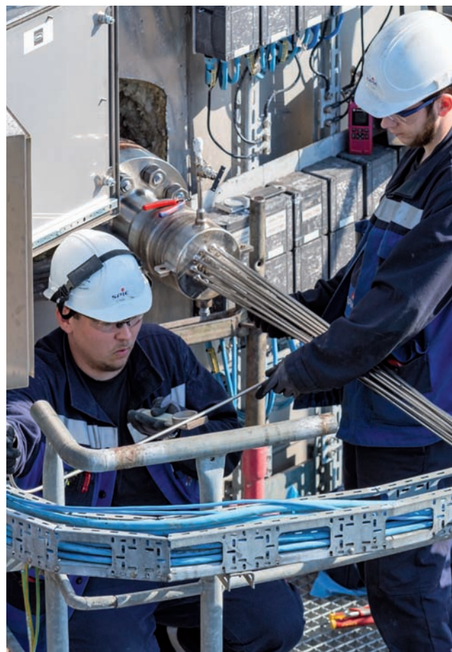
Endress+Hauser a rafinéria spoločne vylepšili viacbodové teplomery s cieľom zlepšiť proces vnútri hydrokrakovacej jednotky. Systém bol nainštalovaný počas plánovanej odstávky.
